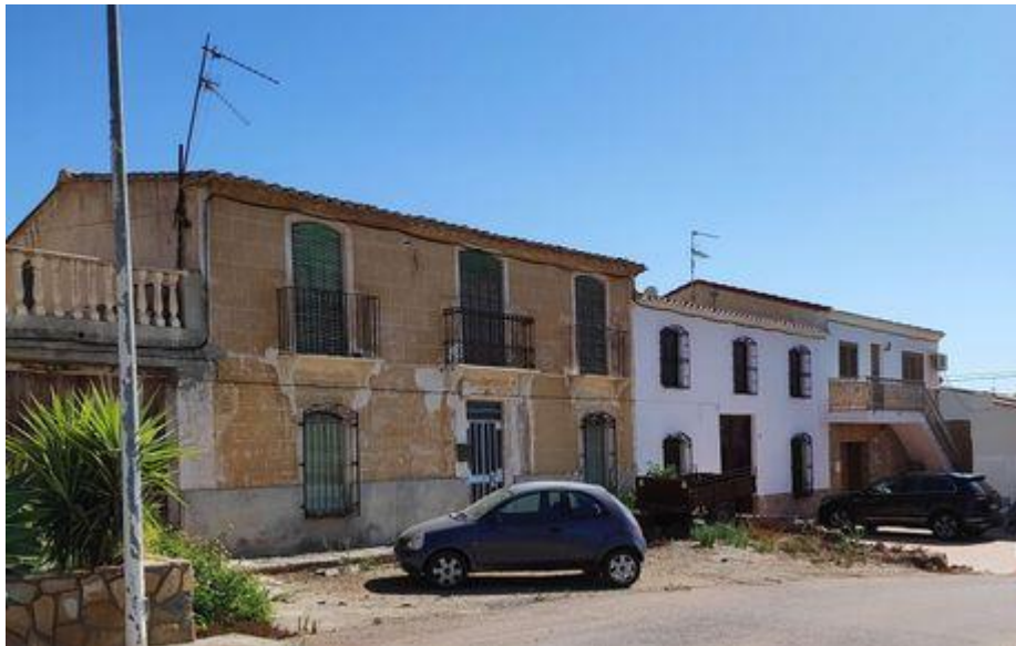
Imagen 8. Vivienda tradicional en estado de ruina junto a vivienda recuperada. Elaboración propia
