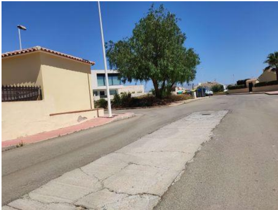
Imagen 19. Acera obstaculizada por farola. Elaboración propia
